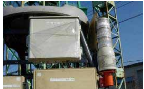
電気制御盤(左)と警報音付き3色表示灯(右)
